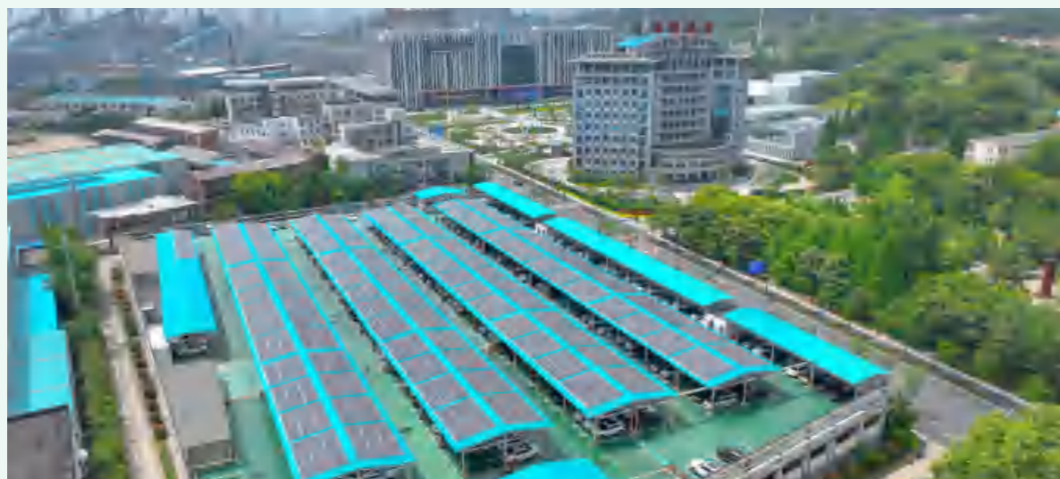
南钢股份在员工停车棚上安装光伏板
